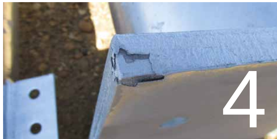
Photo 4 : Exemple de matériel galvanisé nécessitant une réparation.
